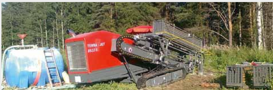
Russland: Firma Reljef bei ihrer längsten HDD-Bohrung. Die Pilotbohrung verläuft über 324 m unter dem Wald. Es wird ein HDPE-Rohr DA 225 mm eingezogen.
