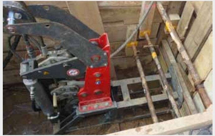
Düsseldorf: Der Seilberster X 400 erneuert über 60 m eine alte Grauguss-Leitung und zieht ein neues HDPE-Rohr DA 110 mm ein.
