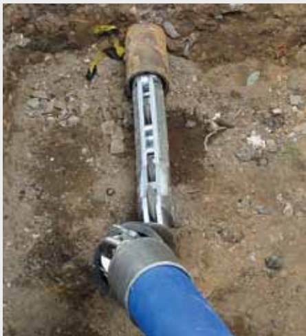
Sao Paulo: Das neue Rollenmesser schneidet erstmalig in Brasilien ein duktiles Gussrohr 5" auf.
