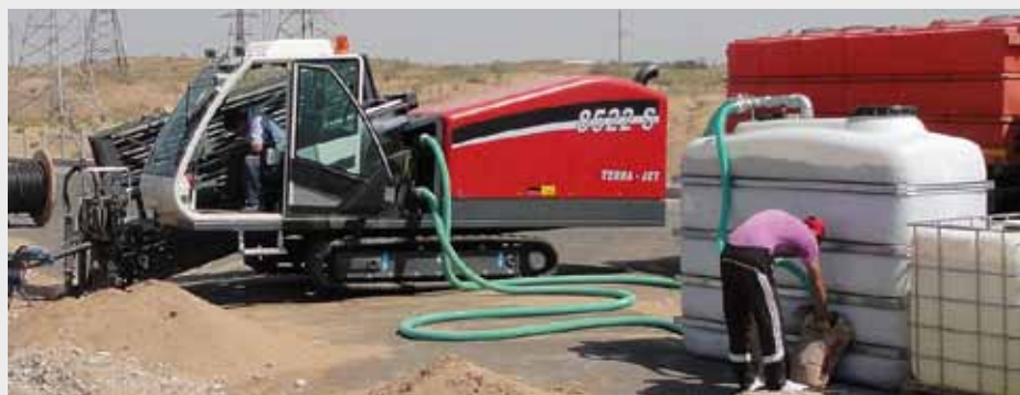
Turkmenistan: Der TERRA-JET 8522 S Premium während des Rohreinzugs. Gerade wird Bentonit eingemischt.
