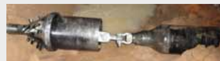
Turkmenistan: Der Aufweitkopf Ø 420 mm und das Stahlrohr Ø 300 mm erreichen die Zielgrube.
